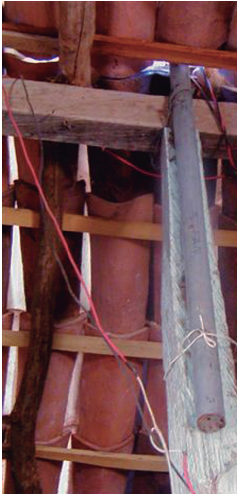
Figura 32 – Instalações e condições precárias de sistemas instalados na Bahia
