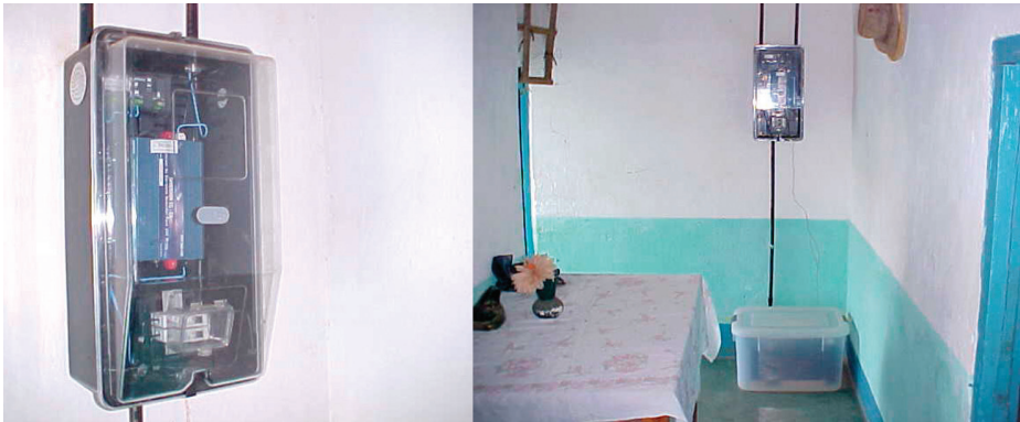
Figura 21 – Caixa com controlador, inversor, disjuntores e bateria
