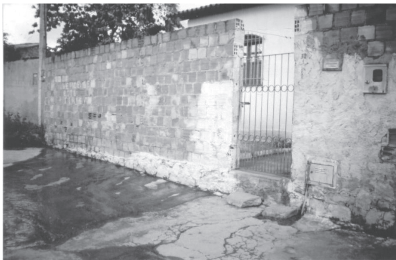
Figura 3 – A água do lençol freático escoando sob o muro residencial no conjunto Feira X - Feira de Santana - BA
