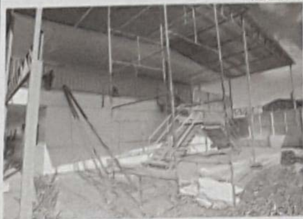
Com parte do telhado danificada, as aulas acabaram suspensas
