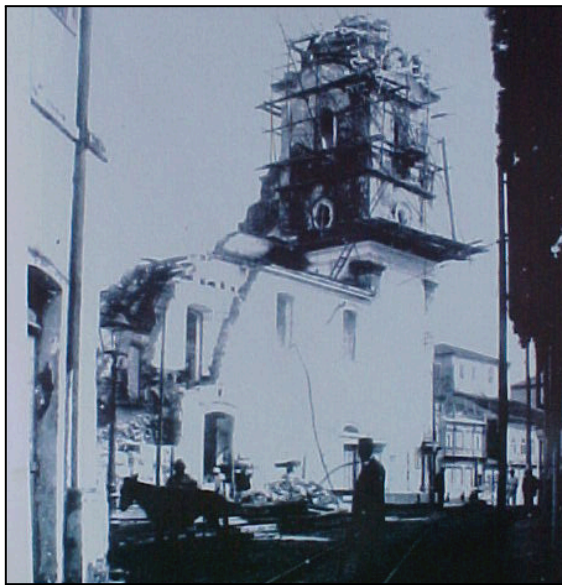
Figura 9 - Demolição da Igreja de São Pedro Velho para abertura da Av. Sete de Setembro.
