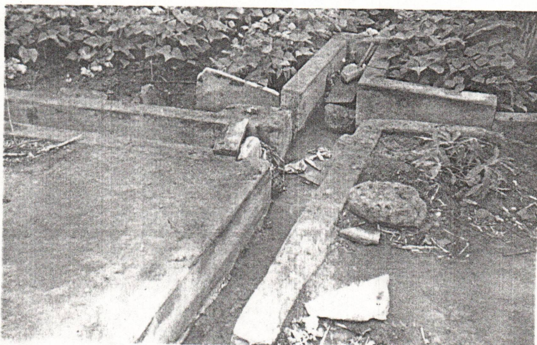
FEITA AS TAPAGENS, A ÁGUA PENETRA NAS ROÇAS DA DIREITA
