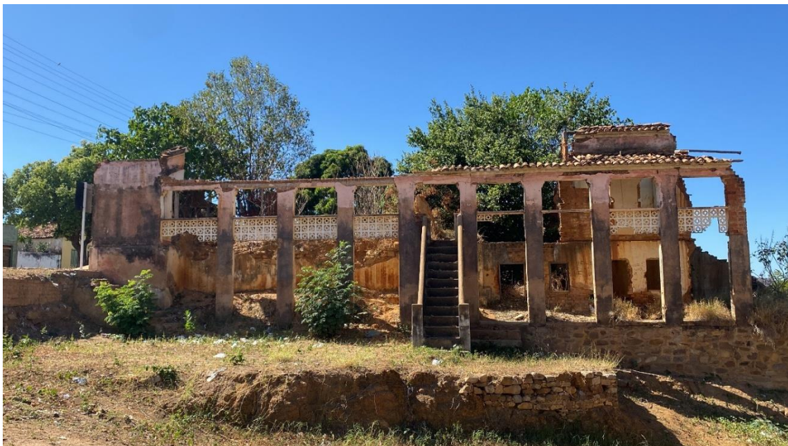
Fotografia 12 - Solar dos Barros em 2025 em estado de ruínas.
