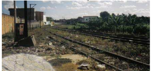
Figura 4.1 ESTADO DE CONSERVAÇÃO DOS TRILHOS
