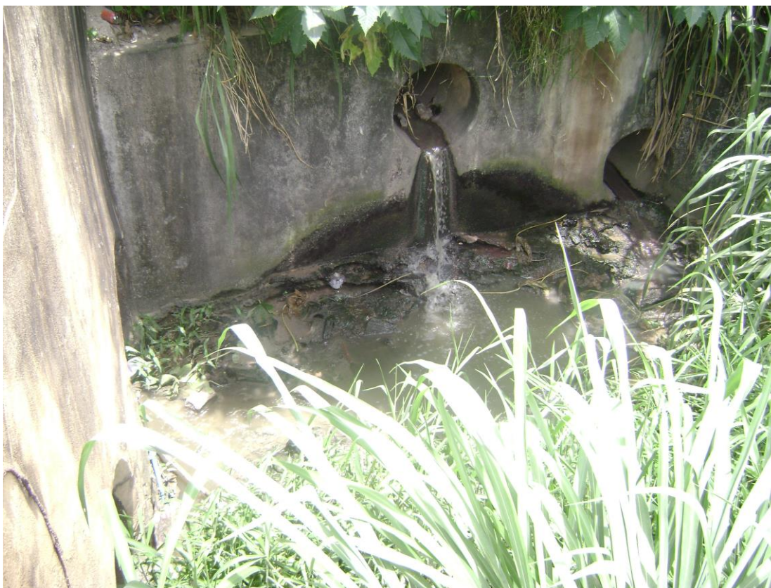
Figura 4.10 – Lançamento de esgoto sanitário em Pitanguinha
