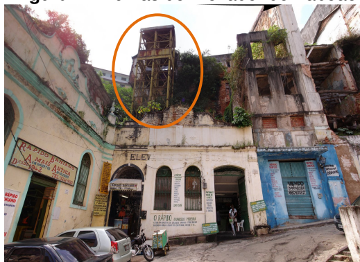
Figura 4 - Ruínas do Elevador do Taboão
