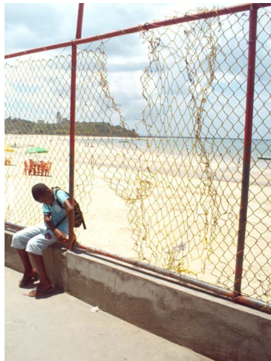
FOTOGRAFIA 14: Alambrado quebrado Fonte: Silva, 2010
