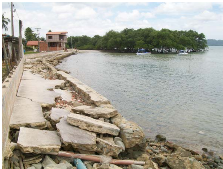
FOTOGRAFIA 7: Via de acesso precária no caminho de Itamoabo para Neves Fonte: Silva, 2010
