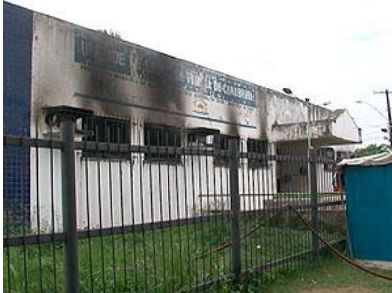
Figura 17 - Fachada do Posto de saúde de Canabrava- após incêndio
