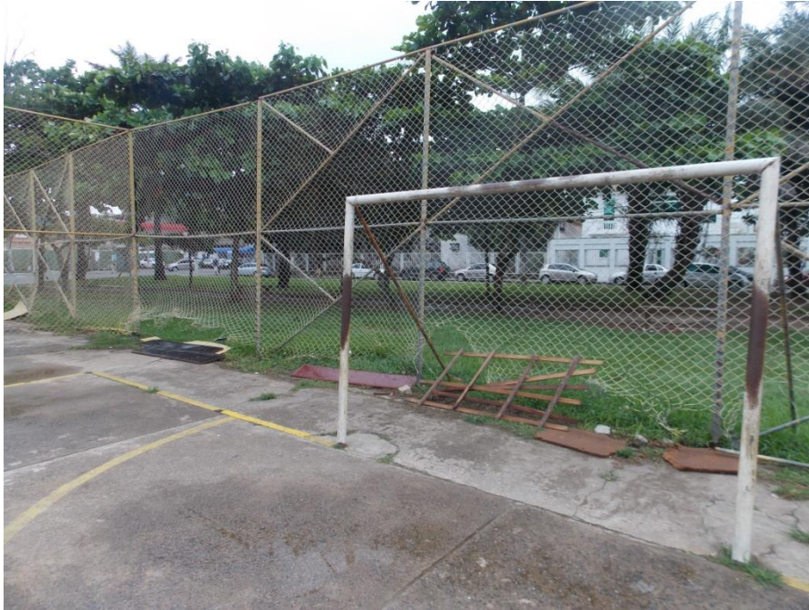
Figura 33 – Improvismo em proteção de quadra esportiva
