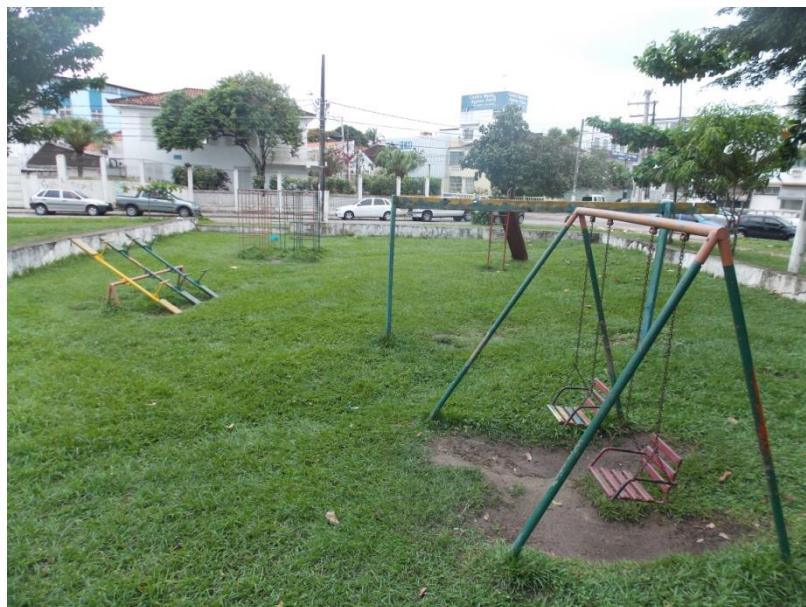
Figura 38 – Parque infantil quebrado com materiais enferrujados
