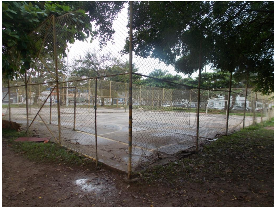
Figura 32 – Alambrados de quadra degradados
