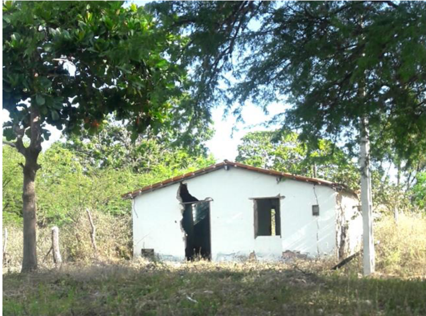
Figura 20 – Habitação em ruínas em Canavieiras
