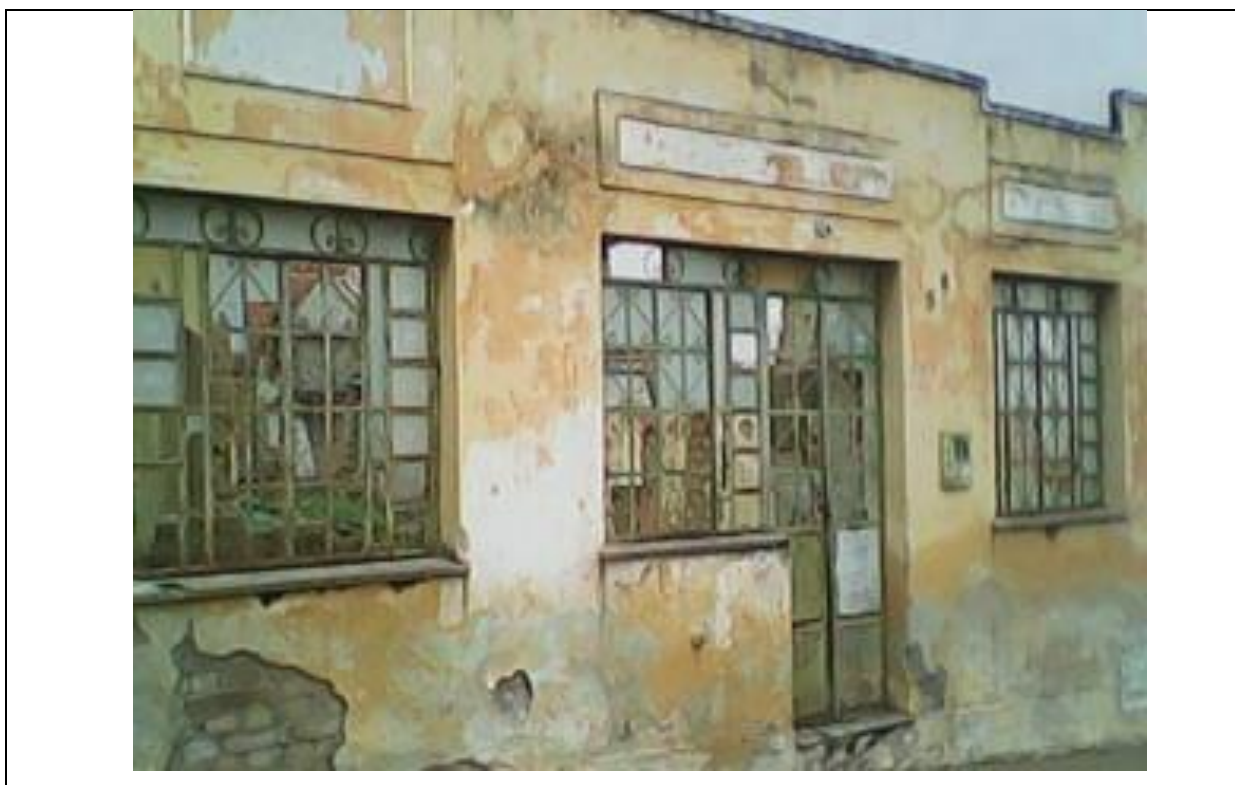
IMAGEM 2 - Ruínas da residência de Joelita de Caboclo na Rua das Laranjeiras.
