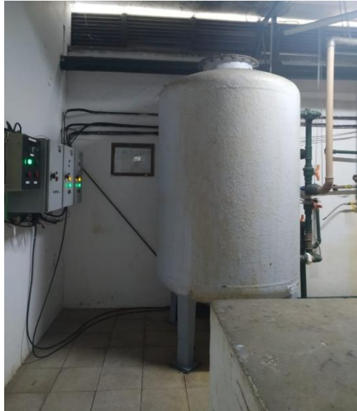
Figura 5 – Filtragem de água vindo do poço
