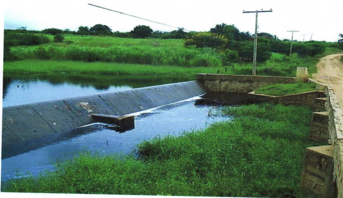
Figura 9: Ponto D. Barragem de concreto de São Bento no período das cheias. Por: Adriano Barreto, fevereiro de 2006.
