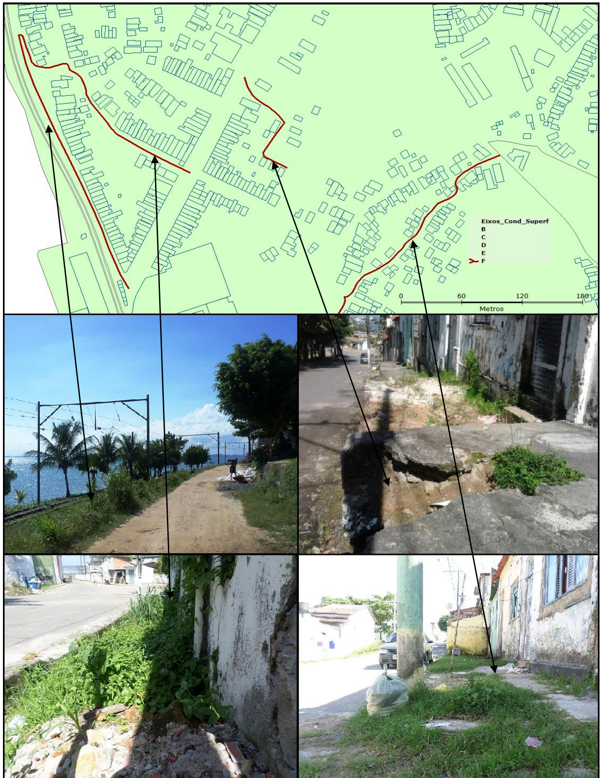
Figura 13: Trechos mais problemáticos do nível de serviço das calçadas, atributo Condições de Superfície.
