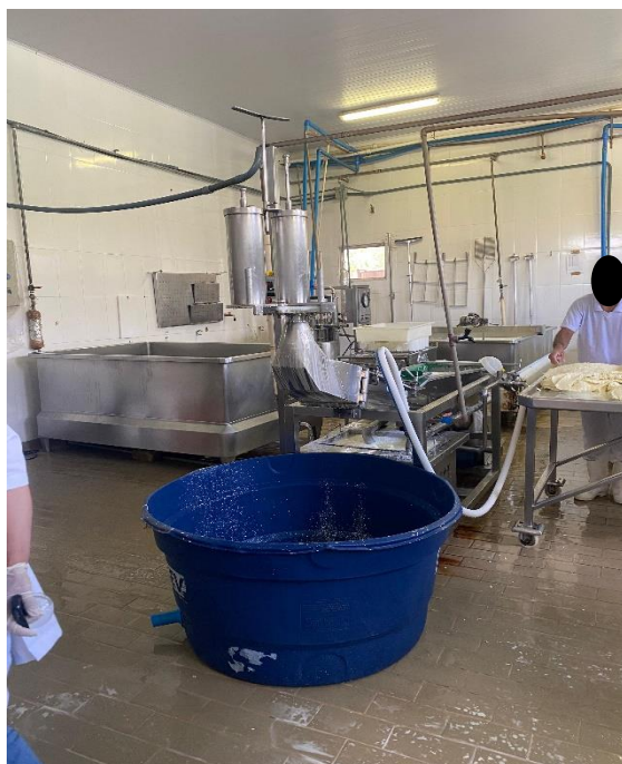
Figura 22: Tubulação para retirada do excesso de soro da produção de queijo e posterior armazenamento. Fonte: Acervo pessoal.
