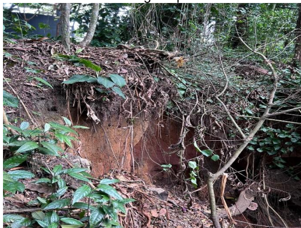
Figura 48 – Erosão do solo provocada pelo volume de águas pluviais.
