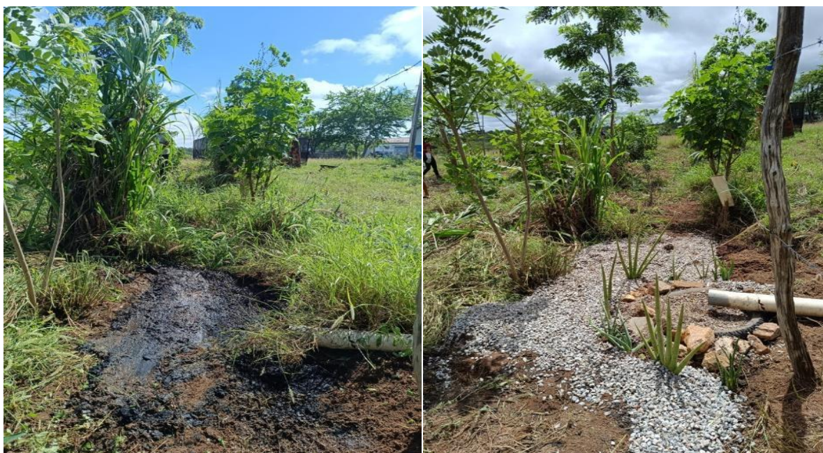
Figura 7: Processo de manutenção do sistema de reuso das águas cinzas.
