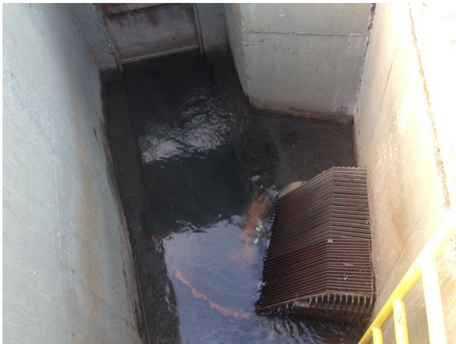
Figura 42: Águas do rio dos Seixos direcionadas para a estação elevatória Fonte: Autoria própria (2021).
