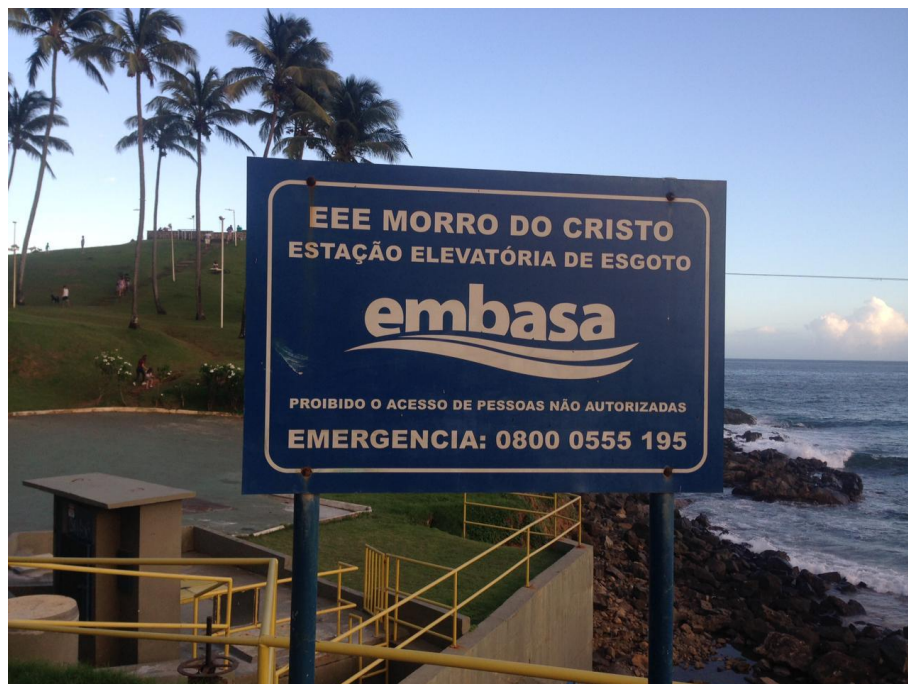
Figura 40: Estação elevatória de esgoto instalada na foz do rio dos Seixos Fonte: Autoria própria (2021).
