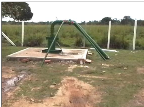
Figura 33 – Captação subterrânea (Poço 1).
