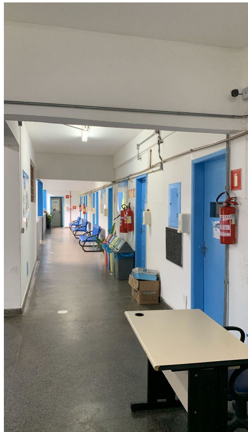
Figura 7 - Sistema de combate à incêndios
