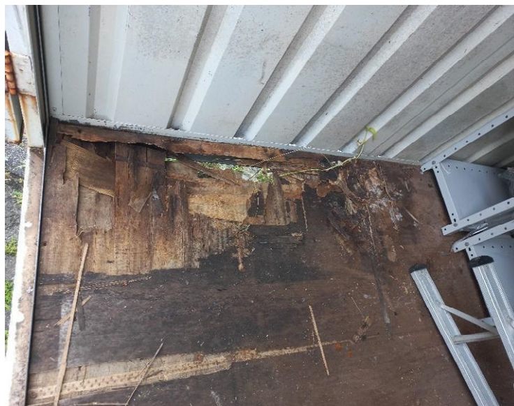
Figura 14 - Entrada do contêiner com piso deteriorado
