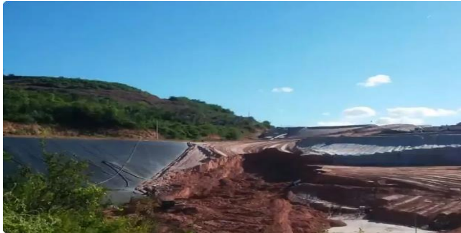
Figura 6 - Deslizamento em manta da barragem de rejeitos B2
