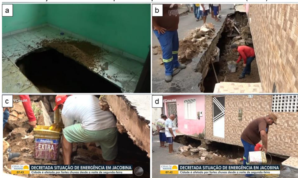
Figura 36 - a) Abertura de cratera em domicílio: Rua São Lázaro (2023); b) Rompimento da pavimentação e exposição do subsolo: Rua São Lázaro (2023); c) Intervenção de moradores para mitigar os danos: Rua São Lázaro (2023); d) Prejuízos econômicos públicos e privados: Rua São Lázaro (2023).
