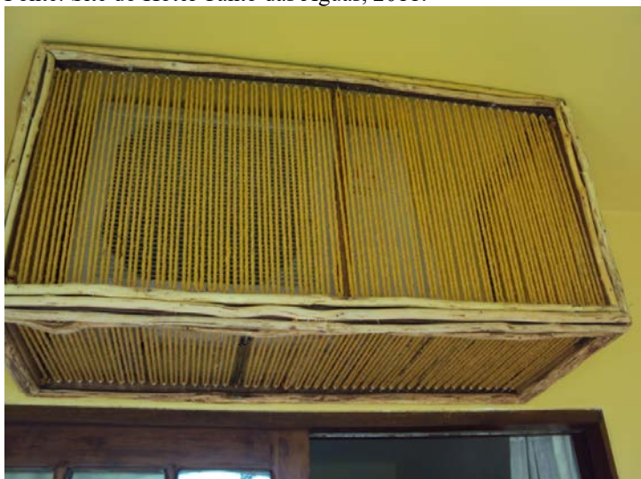
Figura 44: Ar condicionado com estrutura para não impactar na proposta de estar harmonia com o ambiente natural da região. Fonte: Correia, 2011.
