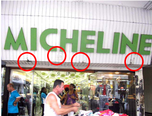
Foto 18: O letreiro da loja “Micheline”, sem manutenção, exibe o estado de conservação ruim (2008).
