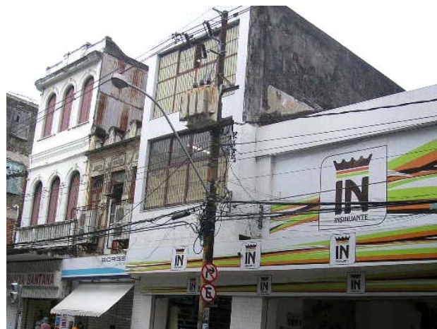
Foto 17: Emaranhado de fios elétricos e de telefonia dispostos sem qualquer parâmetro (2008). Fonte: Acervo da autora.
