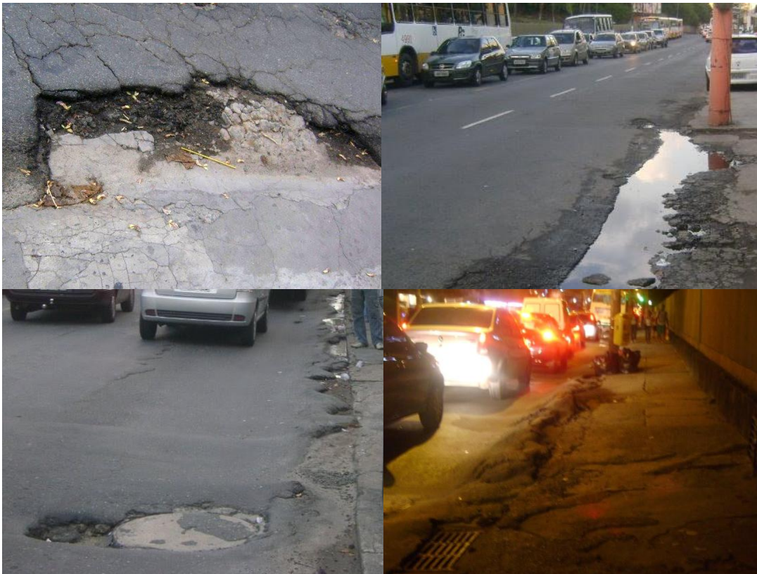
FIGURA 39 – Estado de conservação das vias na Av. Paulo VI, Salvador (BA).
