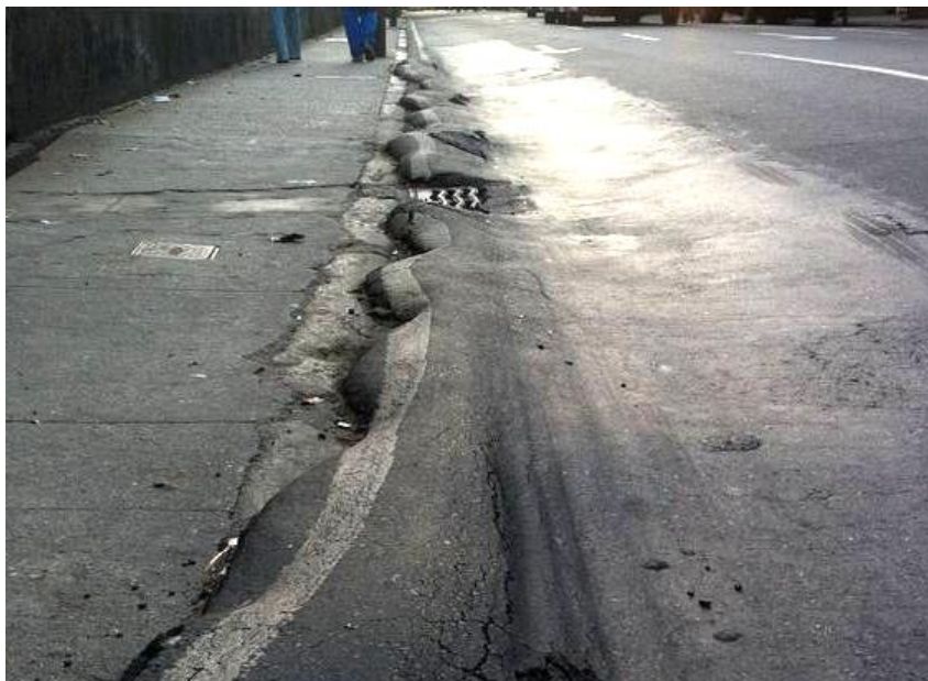
FIGURA 55 – Ondulações no asfalto prejudicam o deslocamento dos ciclistas.
