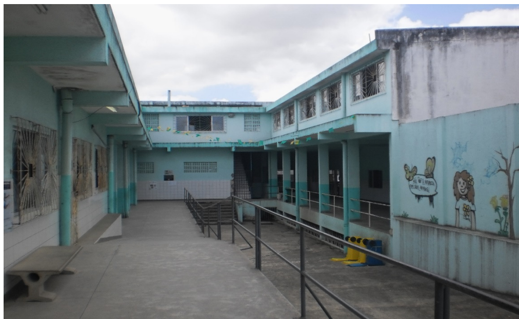
Foto 17 - Paineil Fotográfico: Escola Manoel Henrique da Silva Barradas áreas internas (quadra de esportes, parede da sala de aula danificada e o famoso banho de mangueira)
