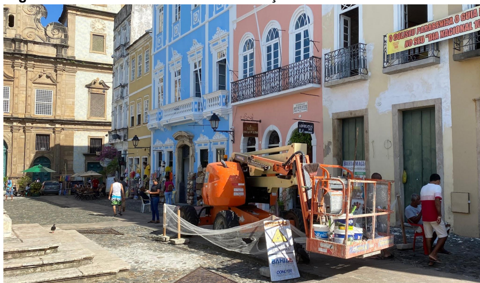
Figura 30 – Barreira Urbanística Manutenção
