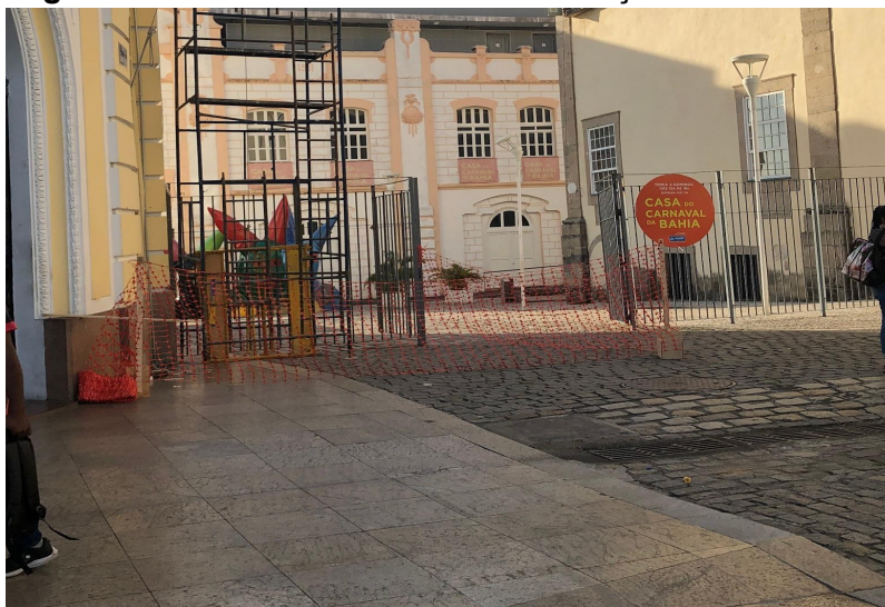
Figura 28 – Barreira urbanística Manutenção
