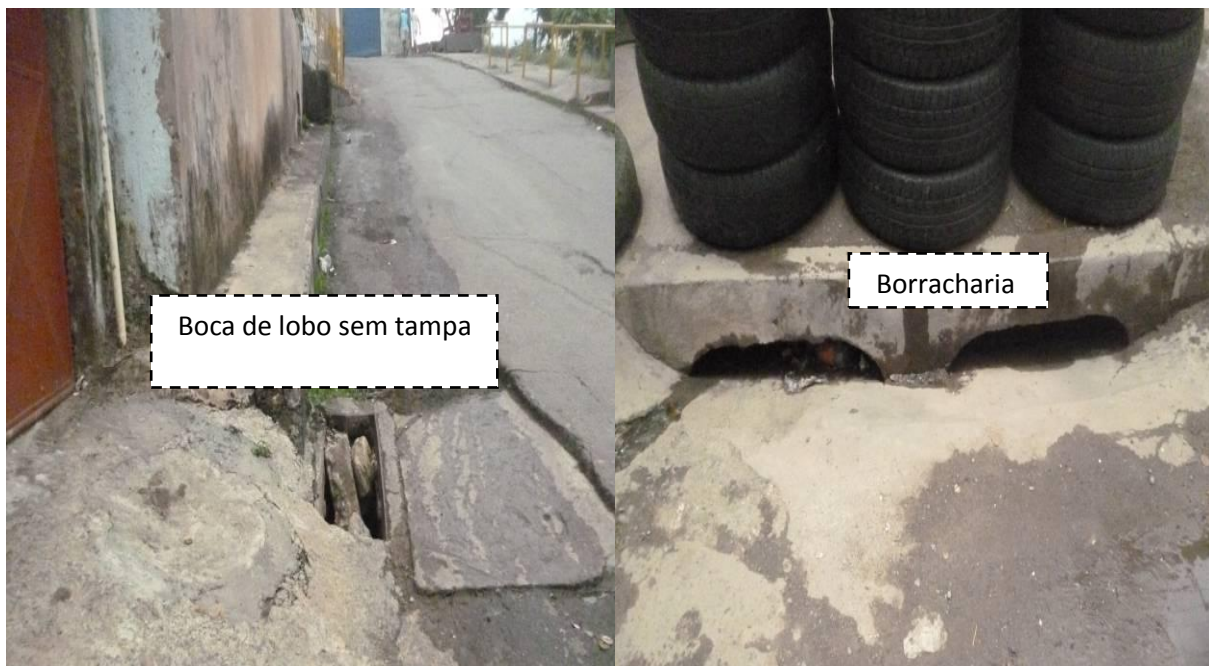
Figura 28- Boca de Lobo sem grade de proteção e serviço de borracharia
