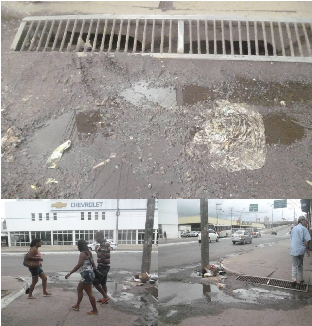
Figura 35-Esgoto escoando a céu aberto
