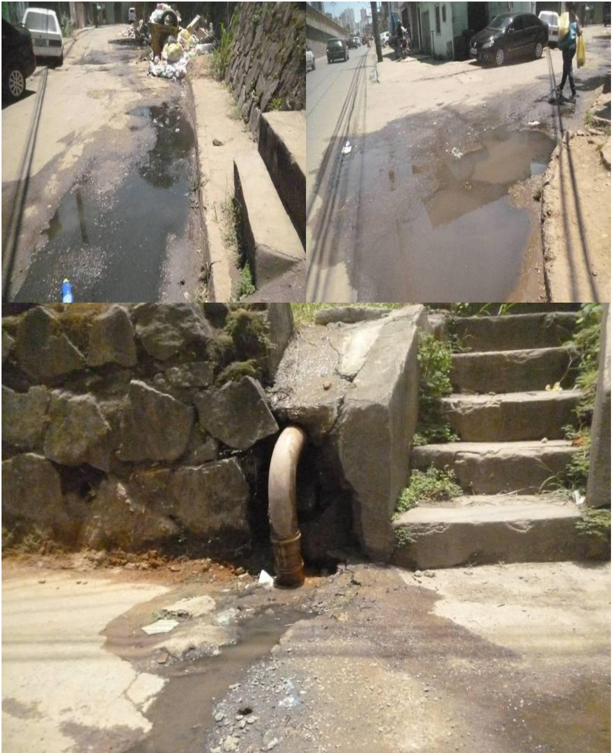
Figura 29- Esgoto a céu aberto
