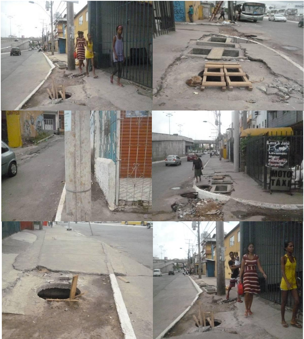
Figura 34- Boca de Lobo sem Tampa e poste no meio do Passeio
