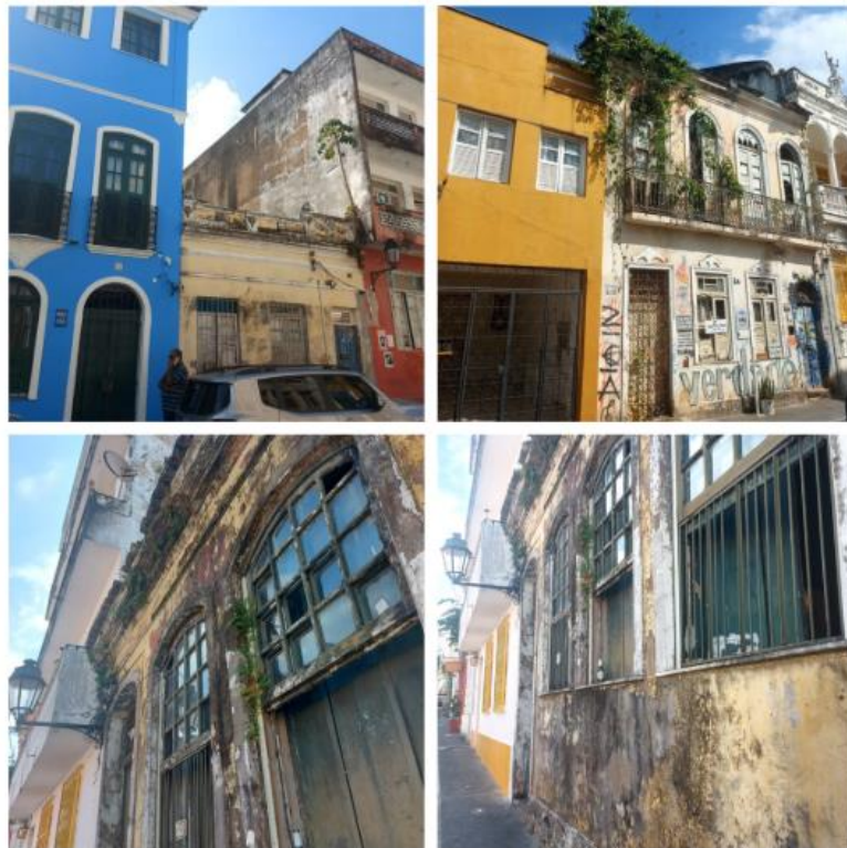
Figura 15- Casarões Tombados em estado de deterioração em Santo Antônio Além do Carmo
