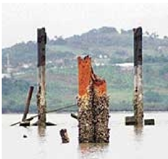
Foto: Tribuna da Bahia, 15 mar. 2002. Figura – 27 – Ferragens de plataforma abandonada, CDJM
