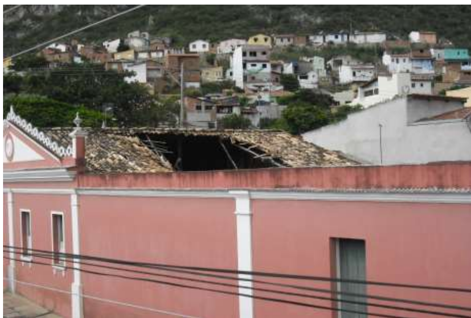
Foto-17 Telhado do Casarão em condições ruins
