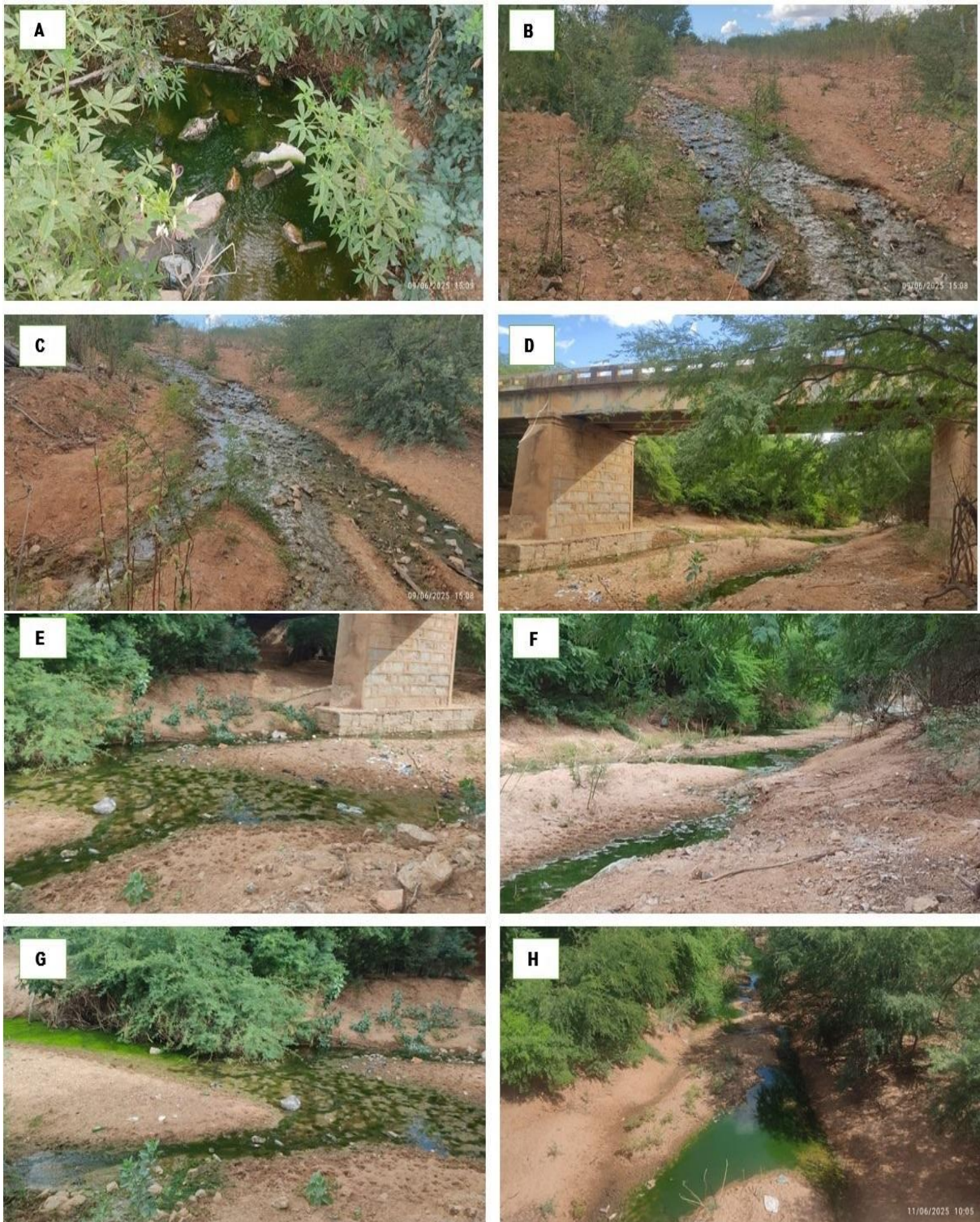
Figura 4 – Fotografias do Riacho Timtim, curso d'água intermitente localizado em Macururé (BA). A-C exibe escoamento de efluente por cano rompido; D apresenta ponte sobre o riacho sem infraestrutura de contenção; E, F, G e H mostra a presença de vegetação aquática com coloração esverdeada e acúmulo de lixo às margens do riacho
