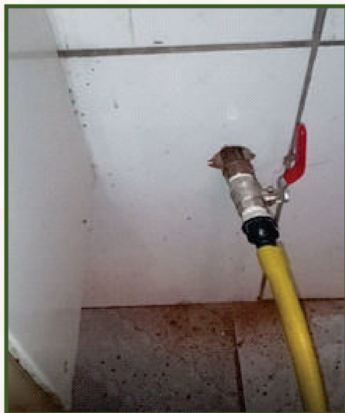
Figura 28 - registro do gás dentro da cozinha
