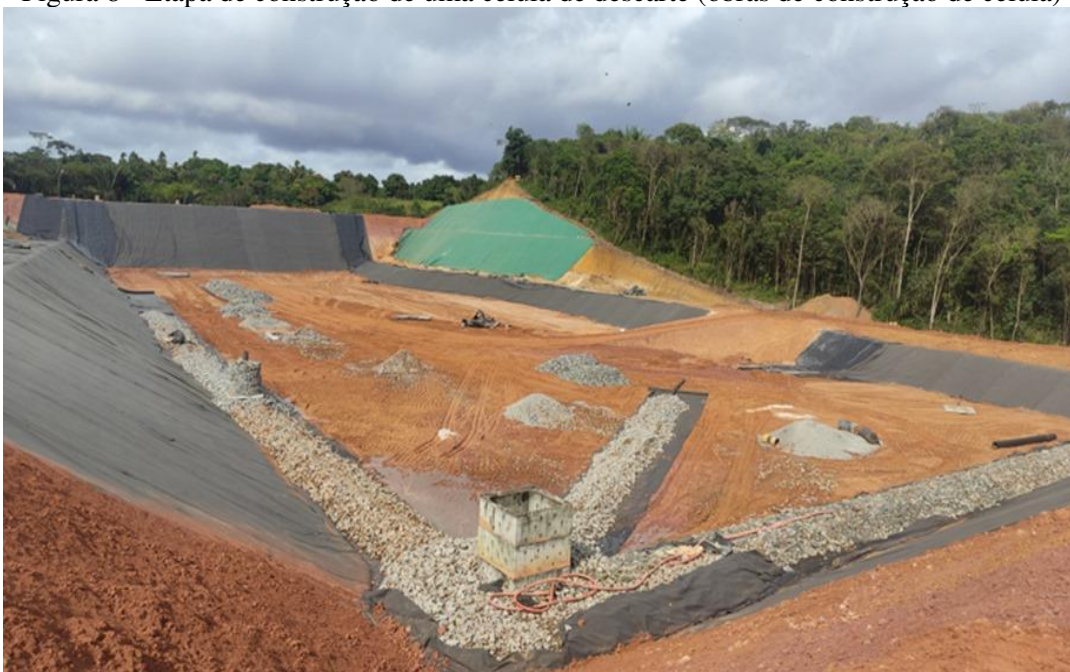
Figura 8 - Etapa de construção de uma célula de descarte (obras de construção de célula)
