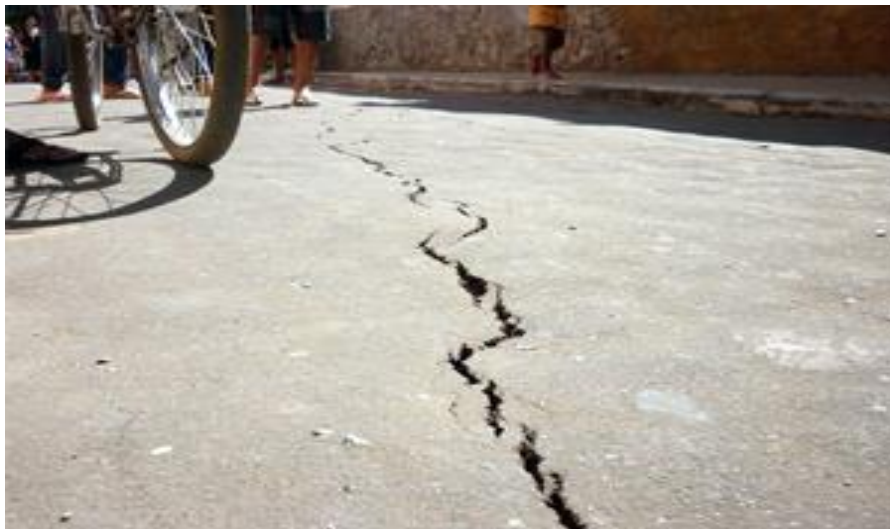
FIGURA 9 – Rachadura na Rua Aurelino Galvão Dourado em Lapão – BA
