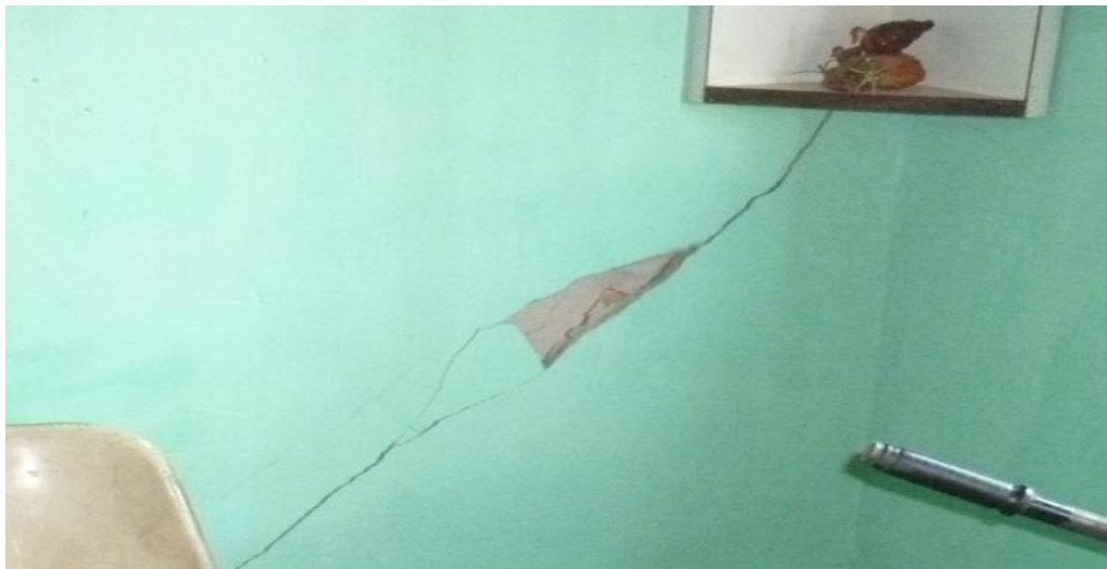
FIGURA 10 – Fissura provocada pelo tremor de terra em Lapão.
