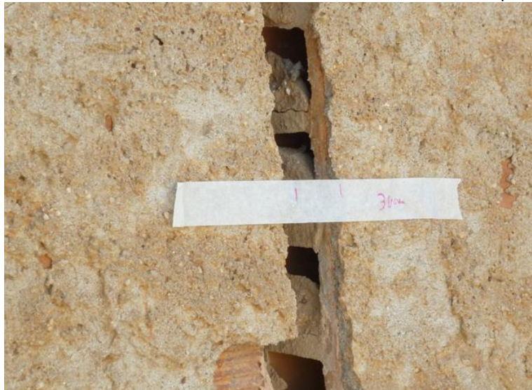
FIGURA 5 – Fissura no muro de uma casa no centro de Lapão
