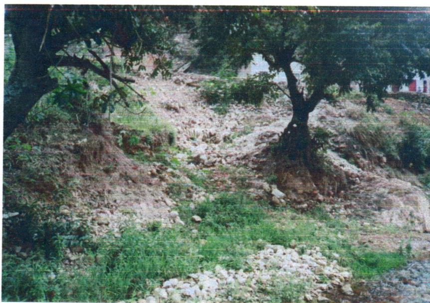
Figura 20 – Retirada da Mata Ciliar – provocando o processo de erosão
