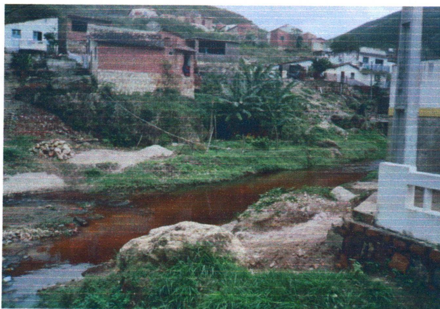
Figura 18 – Muro do Colégio Municipal Dr. Armando Xavier de Oliveira invadindo o leito do rio do Ouro
