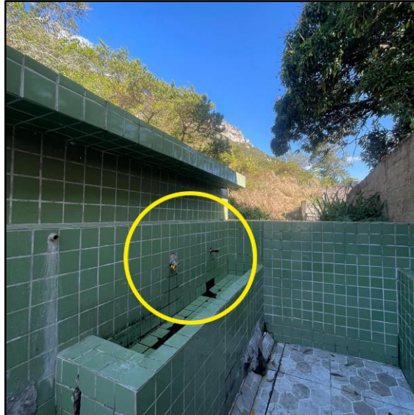
Figura 7 – N1 Captação de Água
