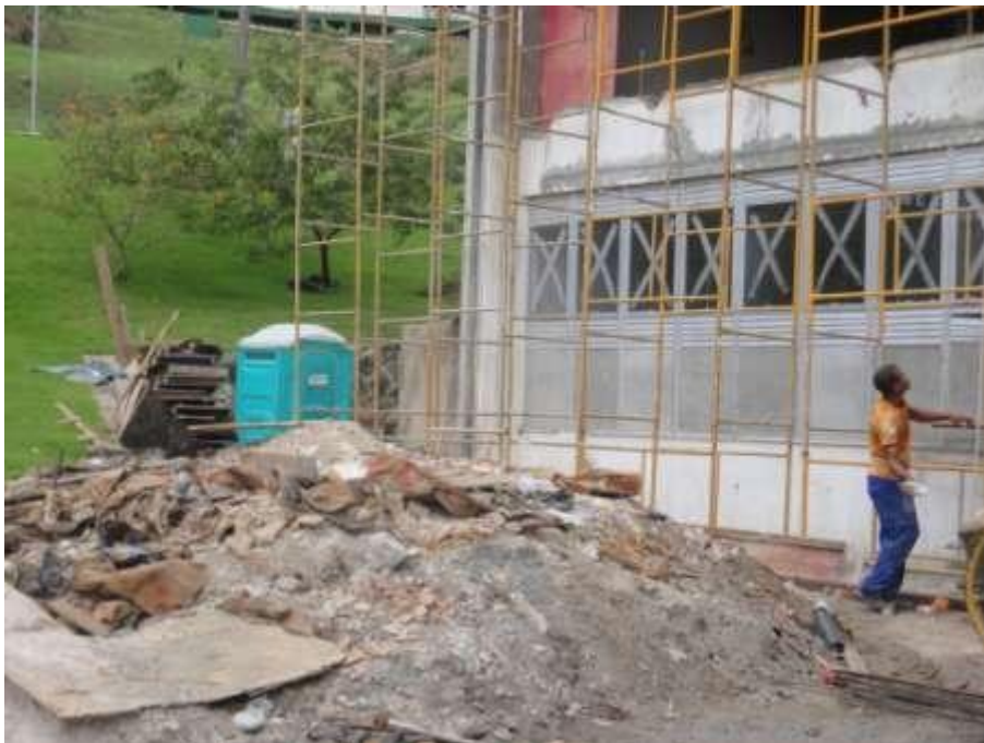
Foto 7 – Resíduos da construção civil gerados no Campus I da UNEB.
