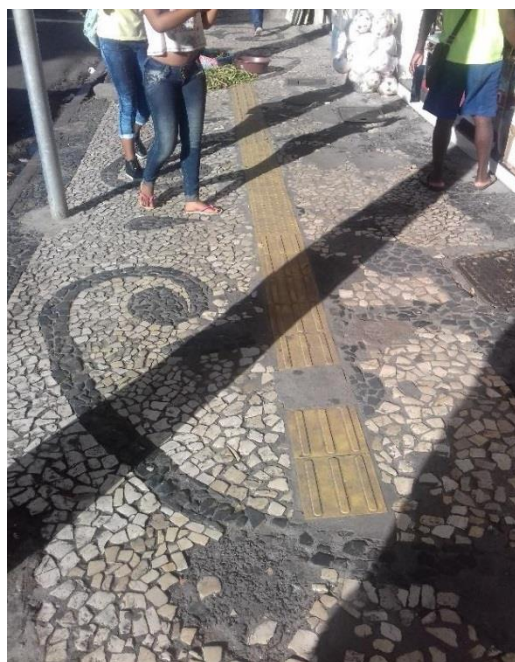
Foto 7: Piso Tátil danificado e com passagem obstruída. Fonte do autor, 2018.
