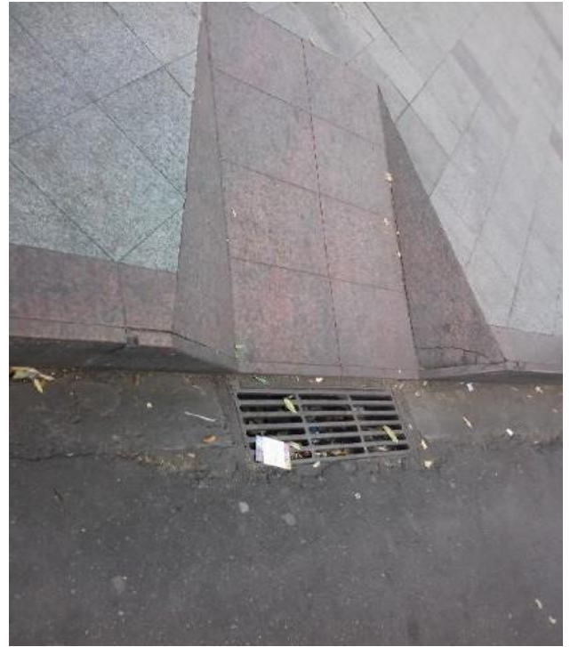
Foto 4: Rampa Desnivelada. Fonte do autor, 2018
