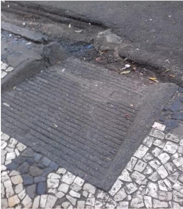
Foto 3: Rampa Desnivelada. Fonte do autor, 2018.
