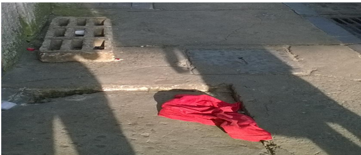
Figura 31 – Elemento de drenagem solto na calçada da Rua Padre Pedro Agostinho Fonte: Elaborado pela autora (2016)
