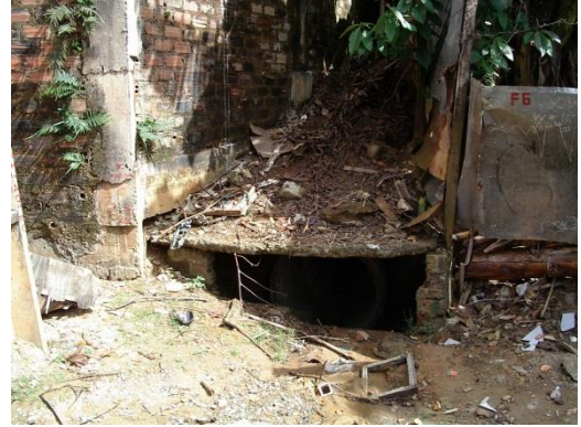
Foto 9 - Bueiro sem tampa de proteção e coberto de mato e lixo Silvia Ogawa, ago. 2003.
