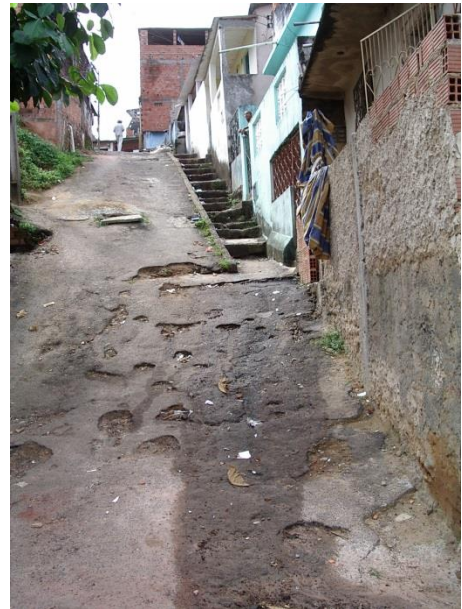
Foto 11 - Escadaria estreita e pavimento sem manutenção Silvia Ogawa, ago. 2003.
