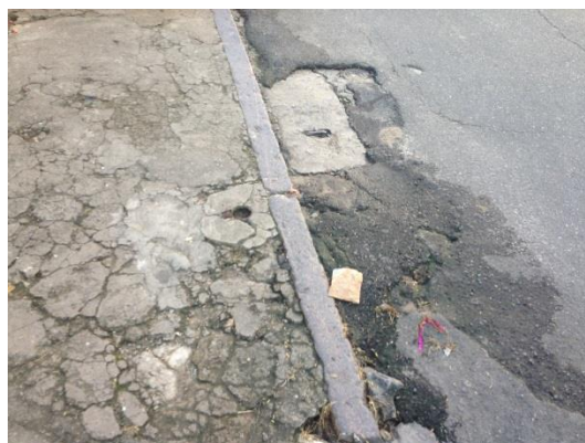
Figura 10: Buracos na calçada.
